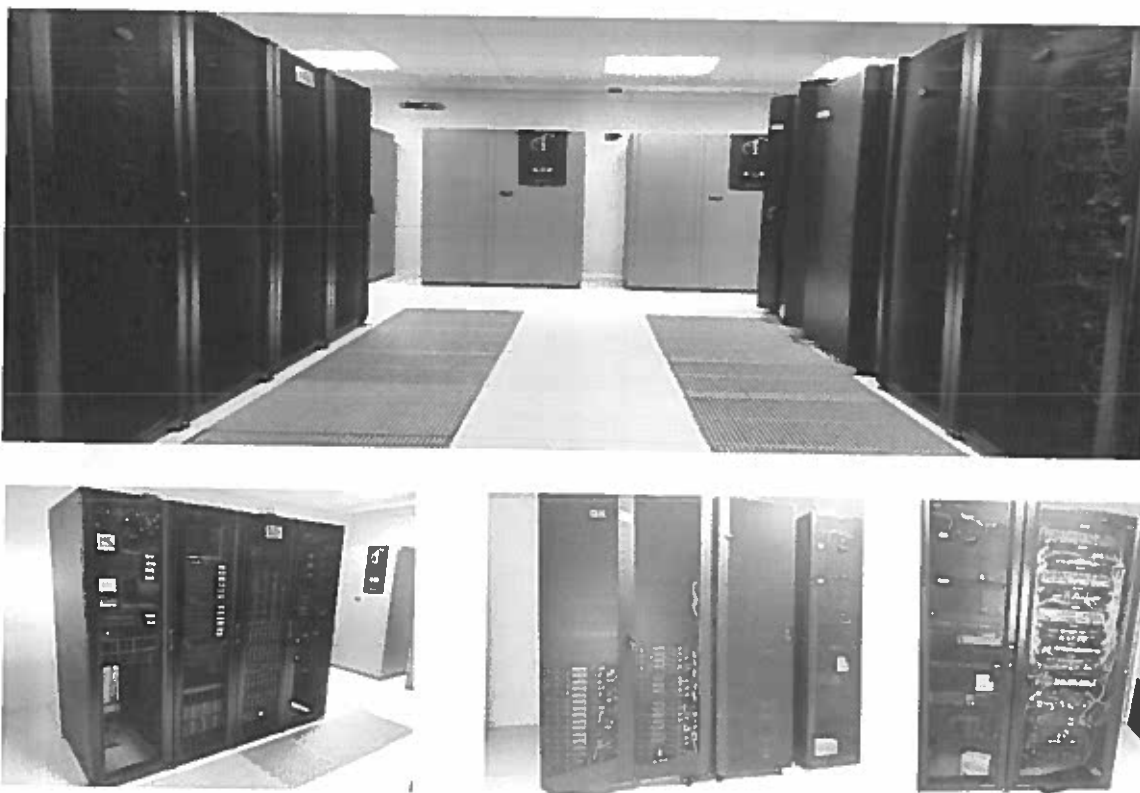
Fig. 1. Centrul GRID RO-14-ITIM; sus: vedere generală; jos: infrastructura ATLAS-GRID, infrastructura HPC și nodul central al rețelei de date
